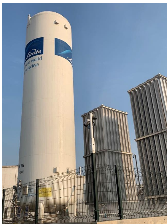
液氮储罐及汽化器
