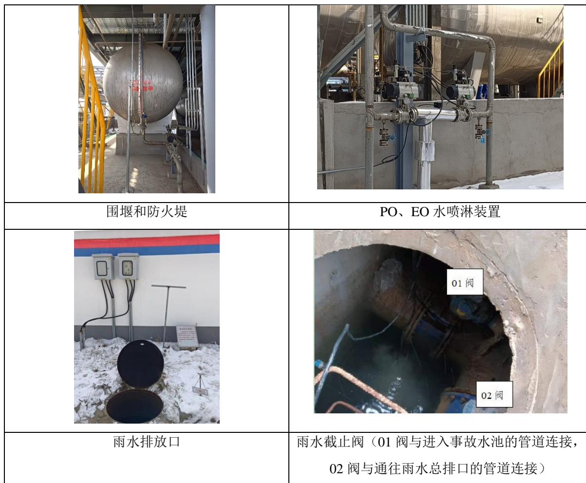
图 4.2-1 厂区现有事故应急处置及截断设施
