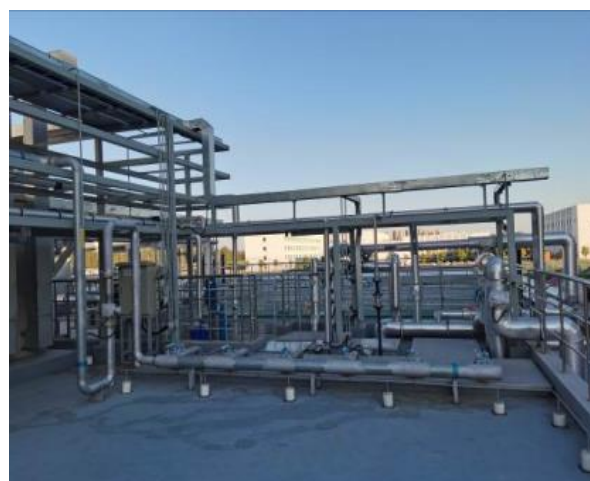
污水处理站管路
