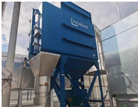
滤筒式除尘设施
