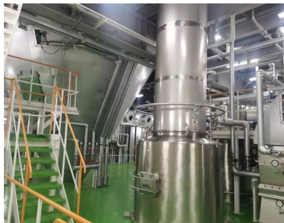
水喷淋+气雾分离设施
