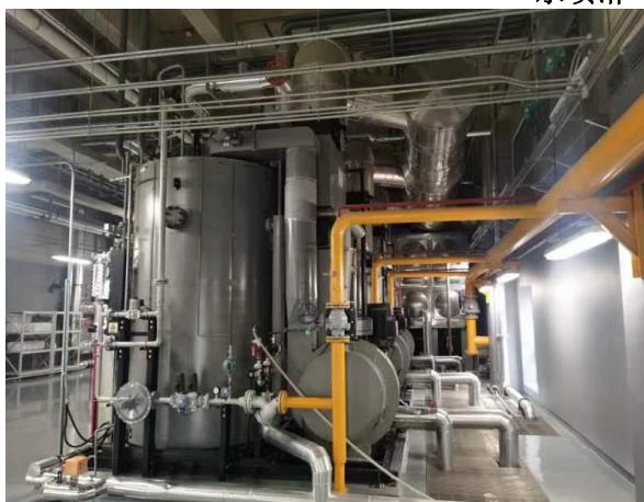
锅炉低氮燃烧器
