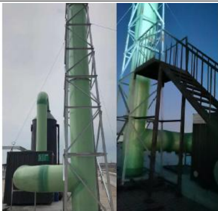
排气筒DA003排污口规范化
